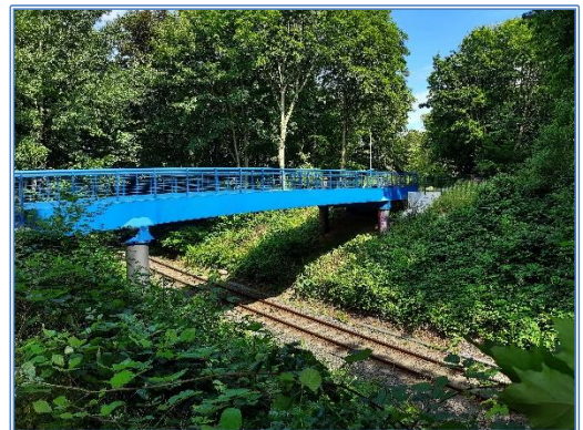
Verbindendes Element vom Sportpark zum Schulkomplex in Ellerbek: die neu erbaute Brücke
